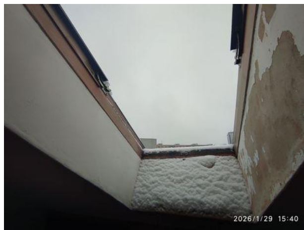
byt. jednotka č.5- chybějící okenní výplň
