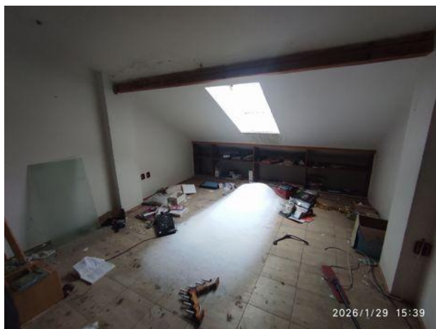
byt. jednotka č.5- obývací pokoj-sníh v interiéru
